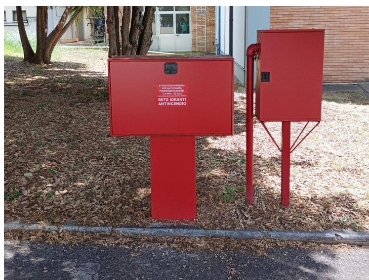
Figura 6: Attacco di mandata per autopompa
