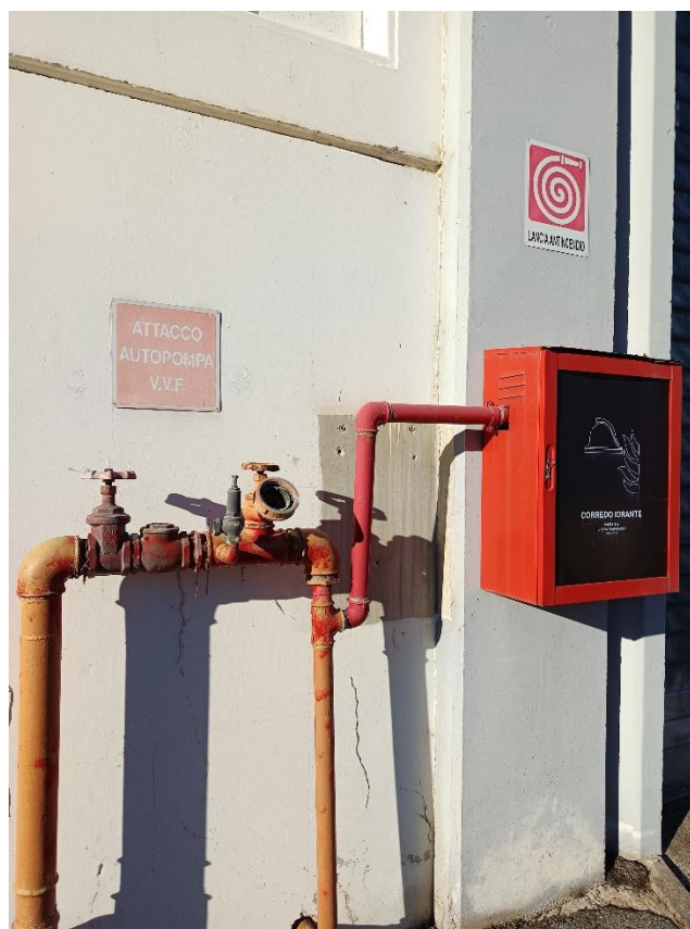
Figura 5: Attacco autopompa VV.F. all'edificio 6b
