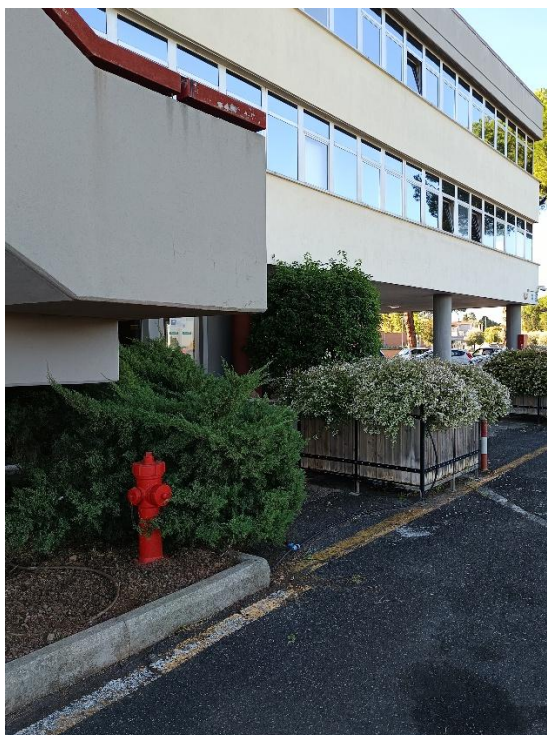
Figura 4: Idrante antincendio all'ingresso dell'edificio 30
